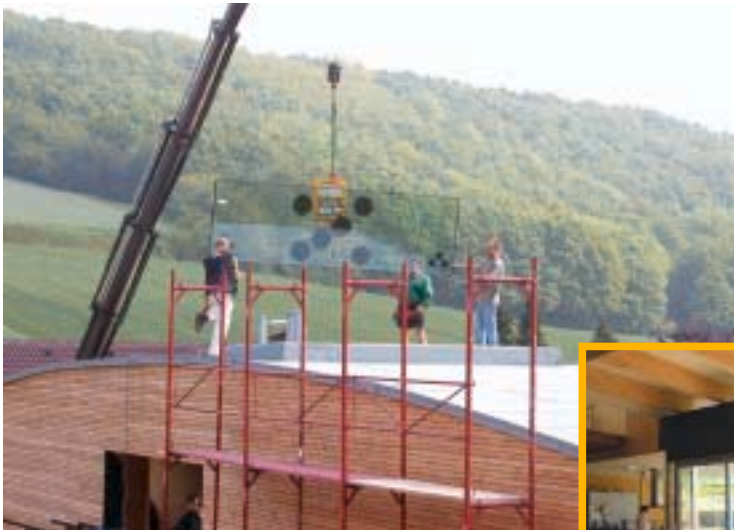
Sollte die kontrollierte Belüftung die Spitzen der sommerlichen Überhitzung nicht ausgleichen können, kann über dieses Hub-Glasdach die Hitze am höchsten Punkt abgelüftet werden.
