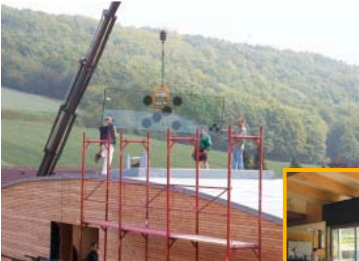
Sollte die kontrollierte Belüftung die Spitzen der sommerlichen Überhitzung nicht ausgleichen können, kann über dieses Hub-Glasdach die Hitze am höchsten Punkt abgelüftet werden.
