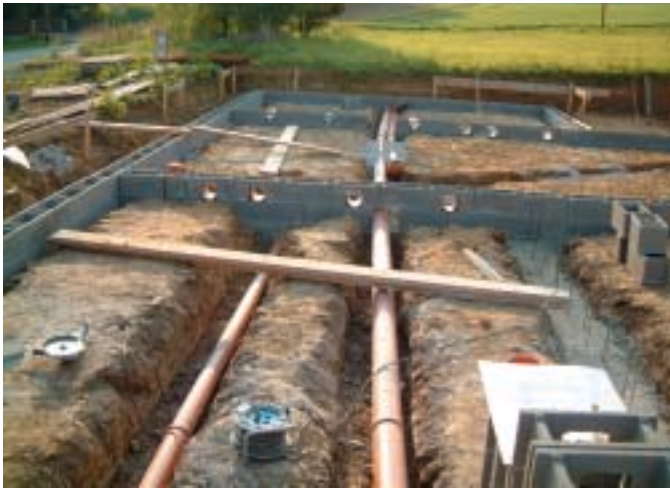
Die Schotter-schicht im Fundamentbereich wird für die Temperierung der Zuluft genutzt.
